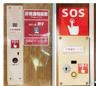
非常通報装置
