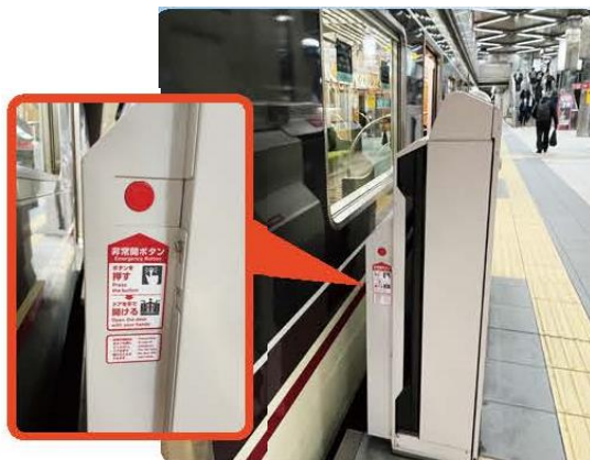
可動式ホーム柵非常用ボタン
