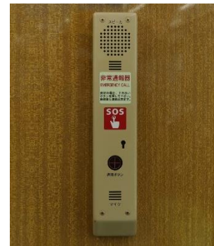
非常通報装置
